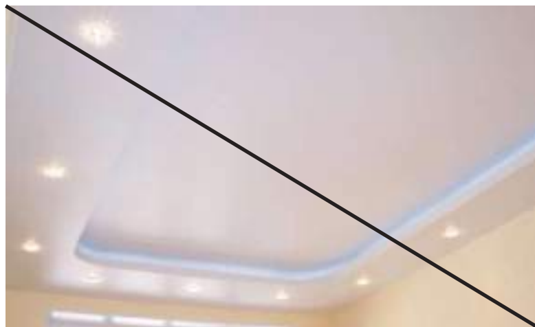
Плохо Многоуровневые гипсокартонные конструкции
