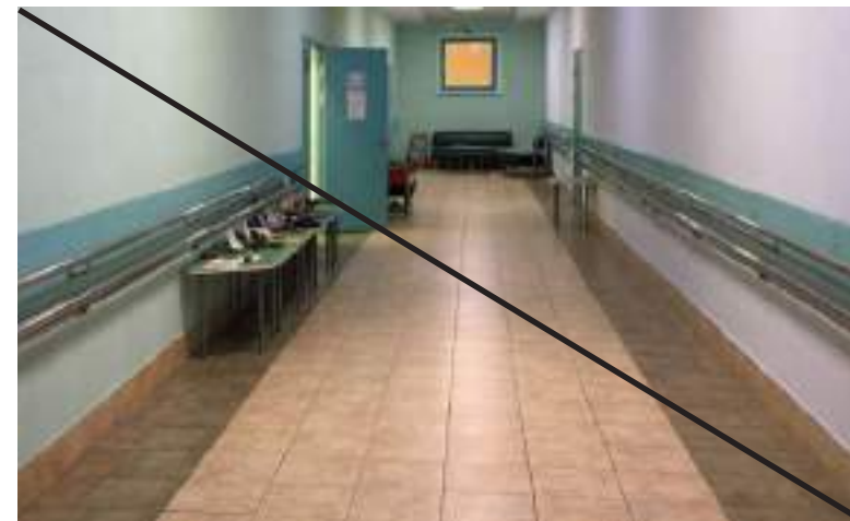
Плохо Керамогранитная плитка с крупными швами
